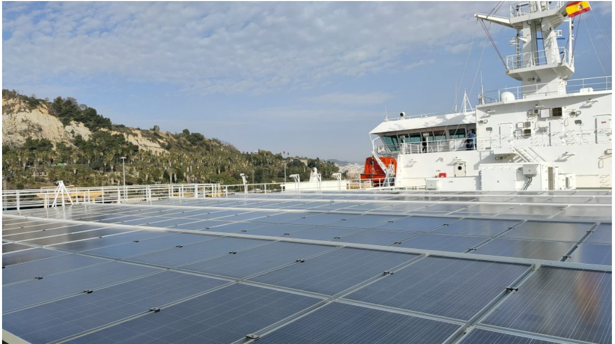
■ Paneles solares en la cubierta del 'Eco Barcelona'
